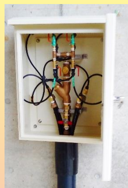
散水コントローラー 制御: 4系統
